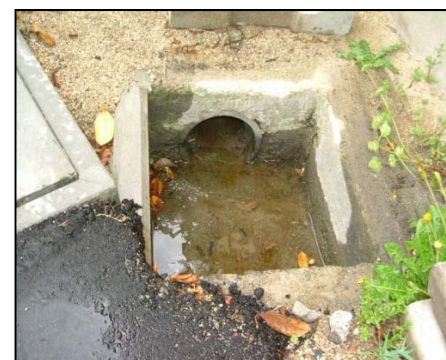
敷地内の側溝、雨水桝の排水不良 【大雨時に敷地内外が冠水するおそれ】
