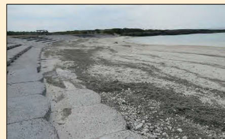
【被災後のスギラビーチ】
