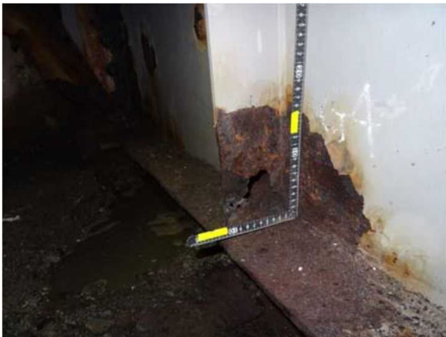
国管理 主桁腐食・欠損
