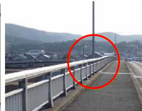
▲中央ヒンジ部の垂れ下がり
