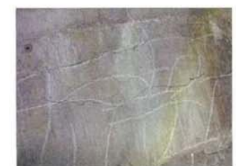
下部工のひび割れ
