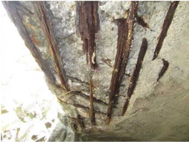
国管理 床版鉄筋露出 ※床版: 橋の裏側
