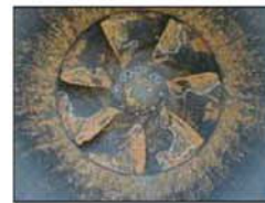
腐食した排水ポンプ場の羽根車
