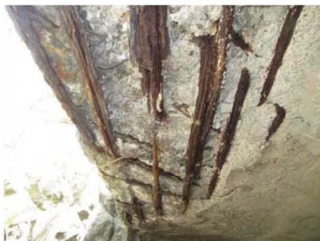
国管理 床版鉄筋露出 ※床版：橋の裏側
