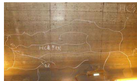
覆工の変状(ひび割れ)
