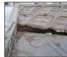
クラックが生じた河川護岸
