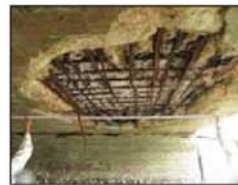
内部の鉄筋が露出した橋梁
