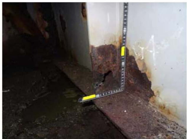
国管理 主桁腐食・欠損
