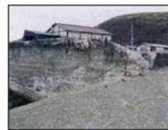
老朽化した海岸堤防
