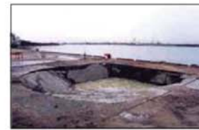
陥没した港湾施設のエロン部分
