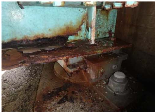
地方自治体管理 主桁腐食
