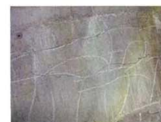
下部工のひび割れ
