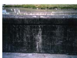
特殊堤における亀裂状況
