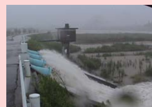
出水時におけるポンプ排水状況 (仲沖救急排水機場)
