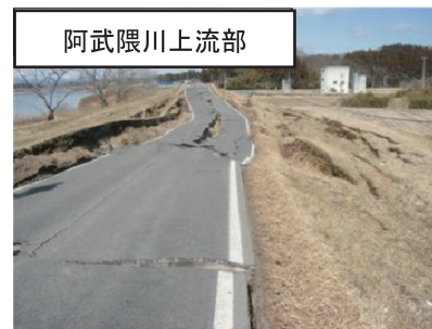
阿武隈川上流部 地震による堤防の被災状況
