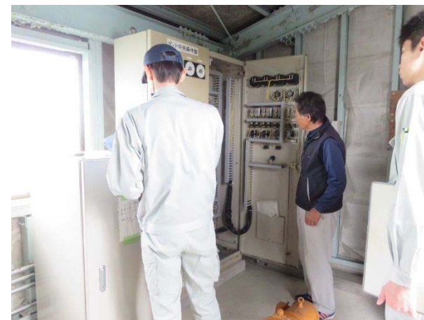
【操作施設での確認】
