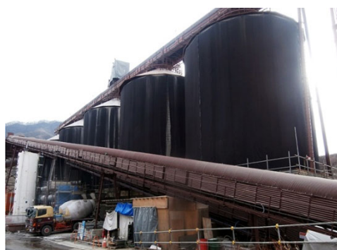
▲骨材貯蔵設備(他ダム事例)
