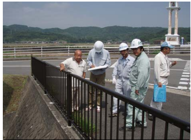
転落防止柵ががらついている！
