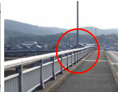
▲中央ヒンジ部の垂れ下がり
