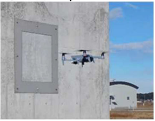
ドローンによる損傷把握
