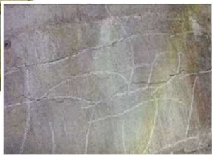
下部工のひび割れ
