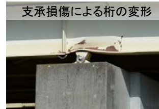
支承損傷による桁の変形 写真-5 九州自動車道 （木山川橋）
