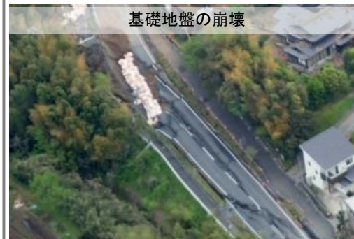
写真-9 国道443号（益城町）
