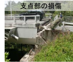
支点部の損傷 写真-6 熊本高森線 （桑鶴大橋）
