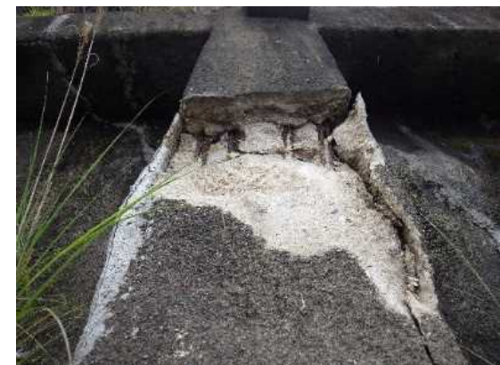
法枠工の老朽化損傷
