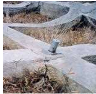
写真 受圧構造物の破損の例
