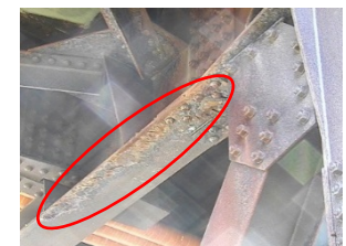
耐候性鋼材に層状の剥離
