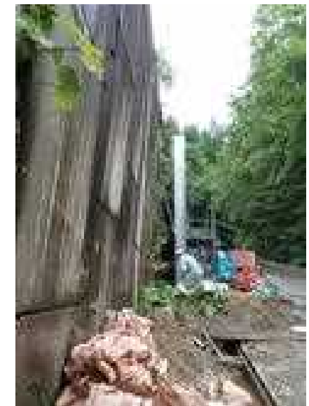
写真 壁面の傾斜の例
