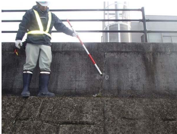
写真2-1-2 特殊堤の老朽化状況
