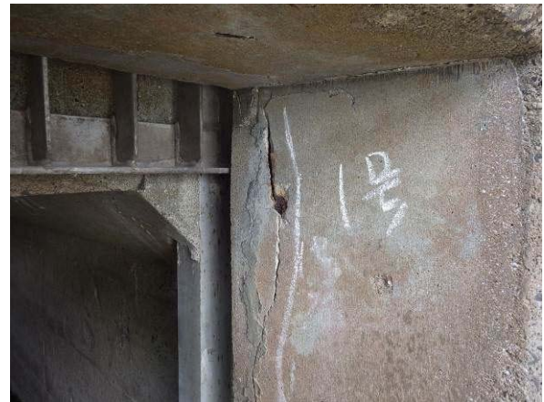
写真2-1-3 長田第1樋門のクラック
