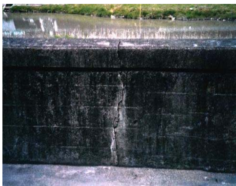
特殊堤における亀裂状況
