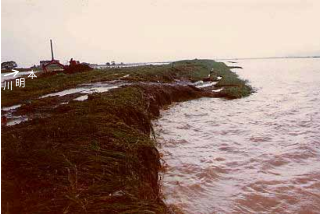
仲沖地区(本川 3k100 付近) の川裏法面崩壊の状況
