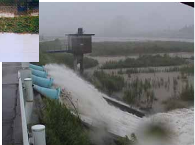
写真4 - 3 - 5 出水時におけるポンプ排水状況(仲沖救急排水機場)
