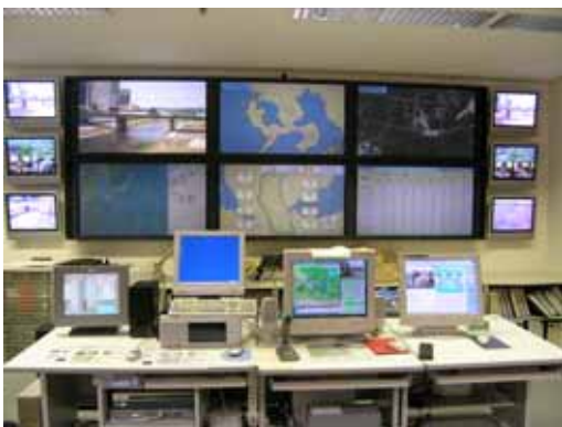
写真4 - 3 - 8 遠隔操作監視システム(長崎河川国道事務所内)
