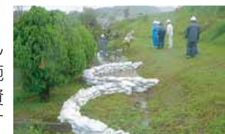
漏水（野田地区）
