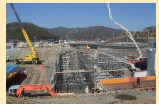
蛇谷川排水ポンプ場の状況
