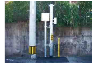
▲古川地区の浸水センサー設置状況
