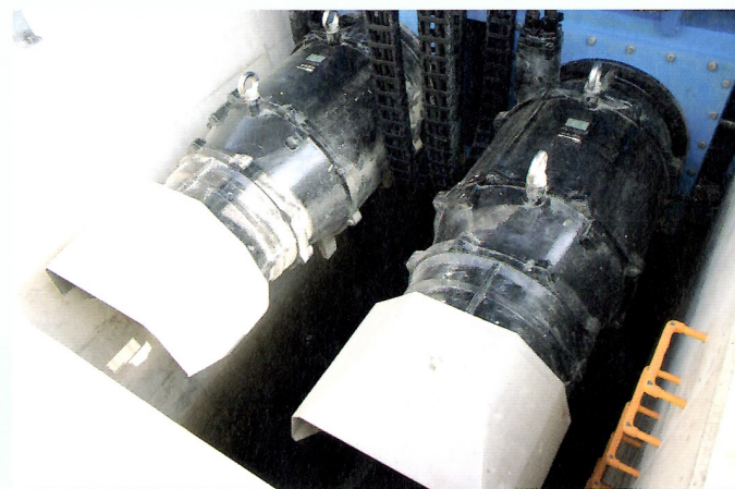
ポンプゲート
