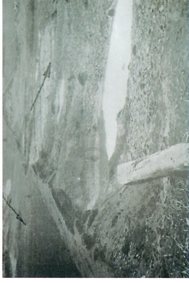
S29.9 台風12号 大瀬川左岸5、400付近の破壊箇所
