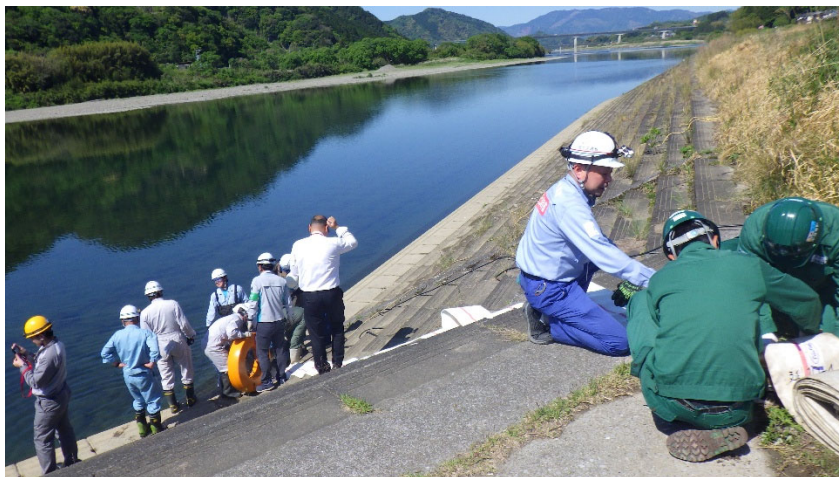
ポンプ設置状況
