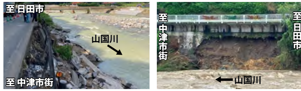
▲R5年7月豪雨による路肩崩落
