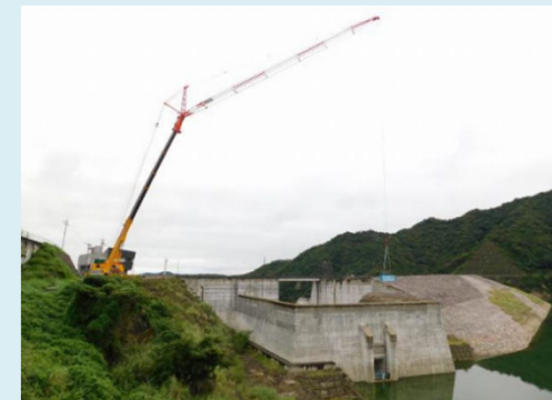
常用洪水吐き閉塞状況
