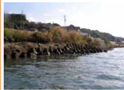
根固の崩落(5k600付近)
