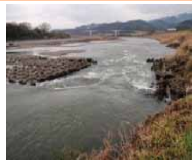
導水路床固の損傷(12k400付近)
