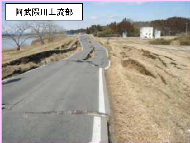
地震による堤防の被災状況
