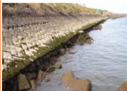
既設護岸の崩壊状況(3k800付近)
