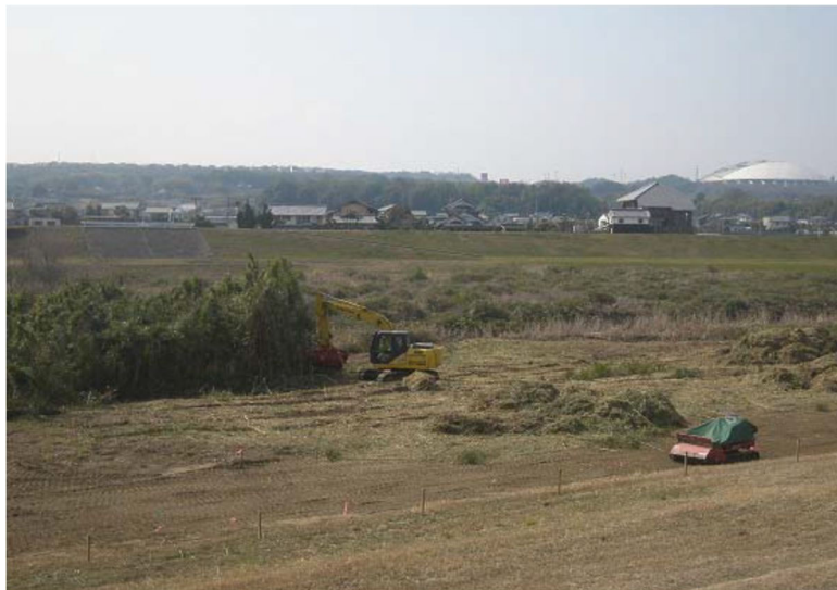
写真 2.1.5 洪水時に支障となる河川内の樹木を河川環境の保全を考慮しながら伐採
