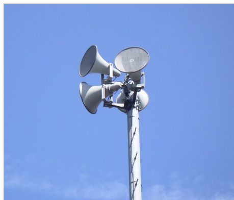
防災行政無線屋外スピーカー
