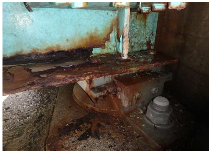
地方自治体管理 主桁腐食
