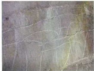
下部工のひび割れ
