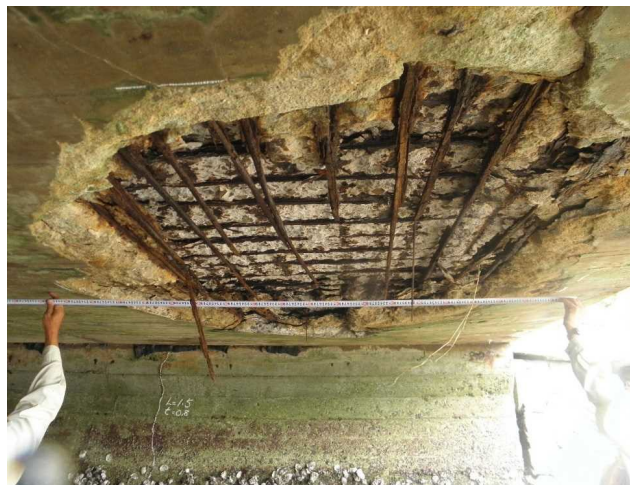
地方自治体管理 床版鉄筋露出
