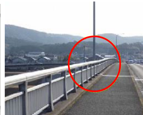
▲中央ヒンジ部の垂れ下がり
