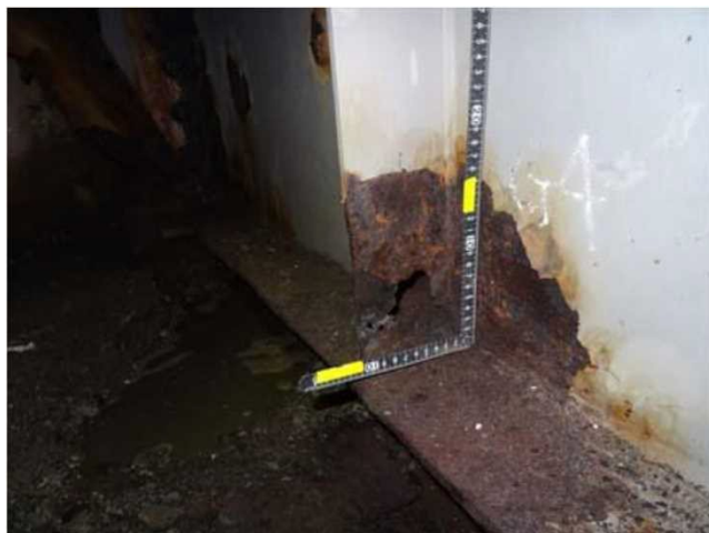
国管理 主桁腐食・欠損
