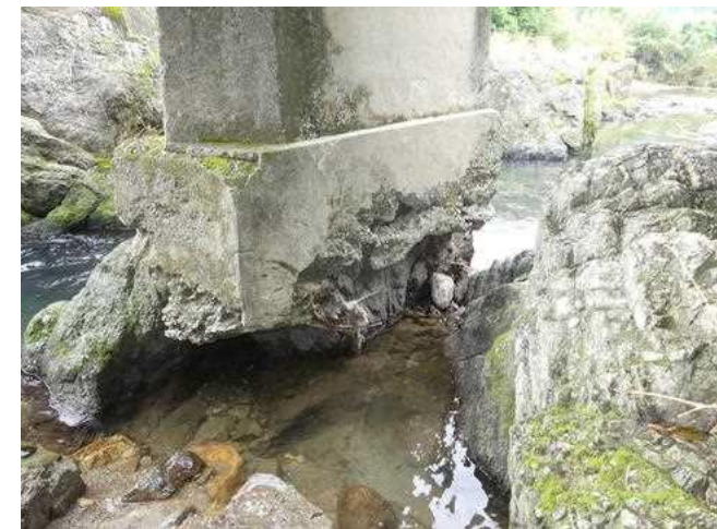
地方自治体管理 橋脚洗掘
