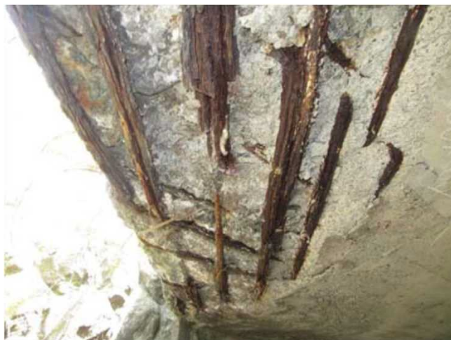
国管理 床版鉄筋露出 ※床版: 橋の裏側
