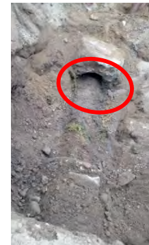
横断水路継ぎ目部に隙間が発生
