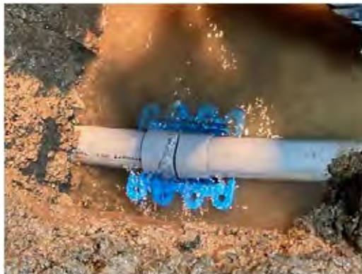
水道管 漏水箇所
