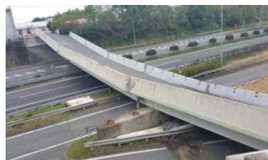
ロッキング橋脚を有する橋の落橋
