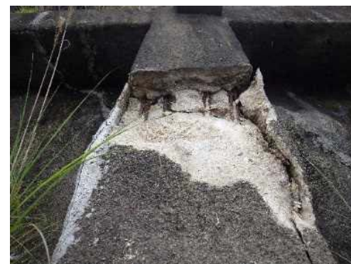
法枠工の老朽化損傷
