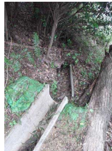
写真 排水溝の破損の例
