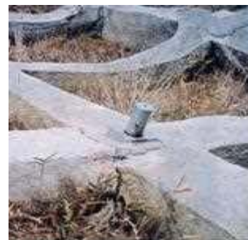
写真 受圧構造物の破損の例
