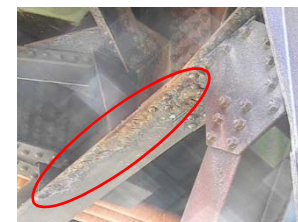
耐候性鋼材に層状の剥離
