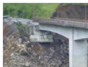
斜面変状による橋台の沈下
