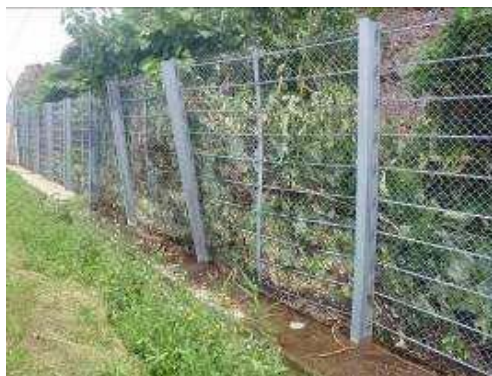
写真 落石防護柵の傾動の例
