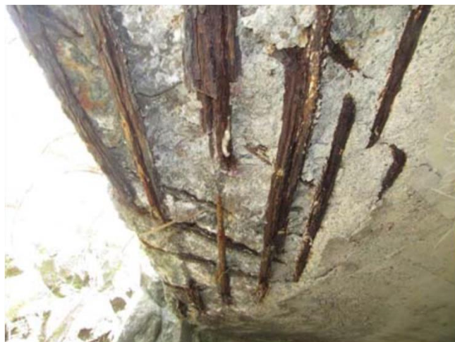
国管理 床版鉄筋露出 ※床版: 橋の裏側
