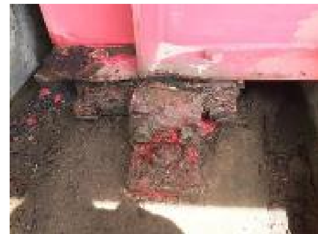
地方自治体管理 支承腐食
