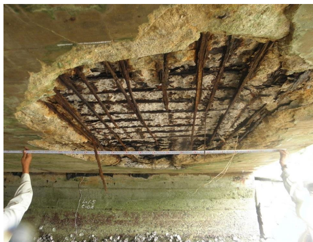
地方自治体管理 床版鉄筋露出
