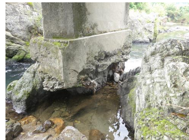
地方自治体管理 橋脚洗掘
