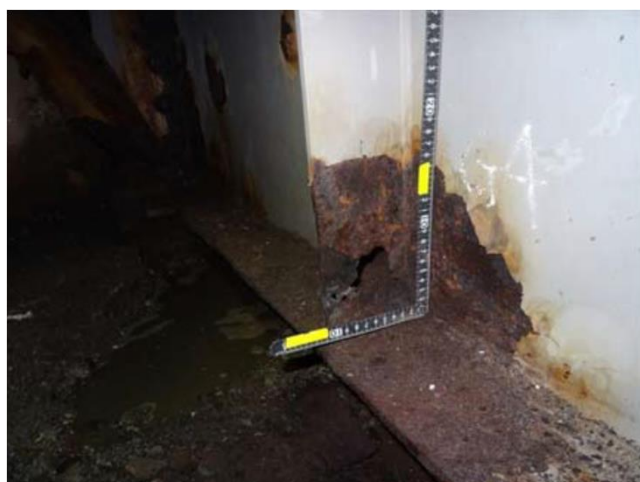
国管理 主桁腐食・欠損
