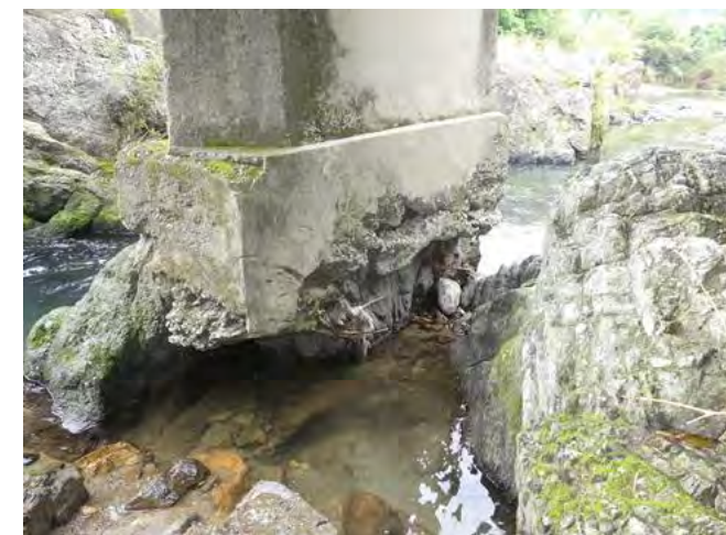
地方自治体管理 橋脚洗掘
