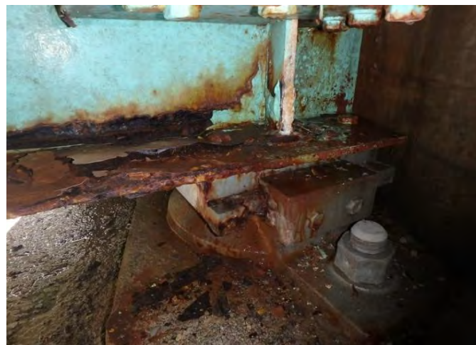
地方自治体管理 主桁腐食
