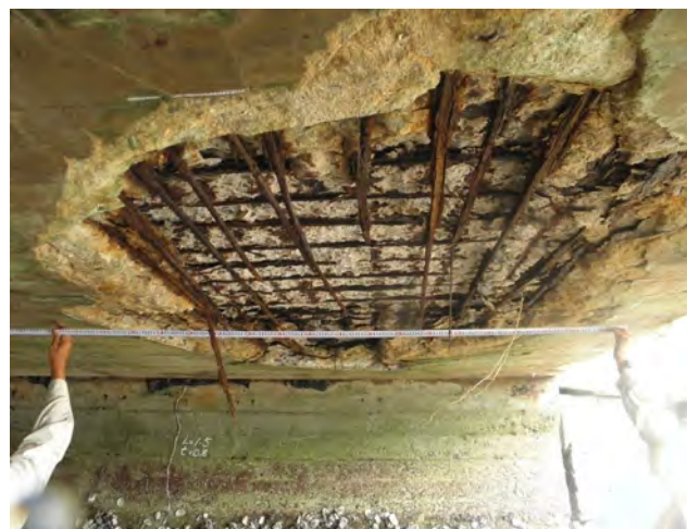
地方自治体管理 床版鉄筋露出
