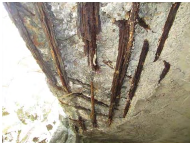
国管理 床版鉄筋露出 ※床版：橋の裏側
