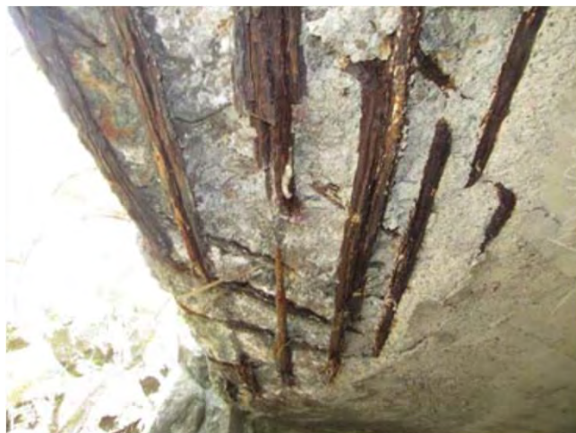
国管理 床版鉄筋露出 ※床版：橋の裏側
