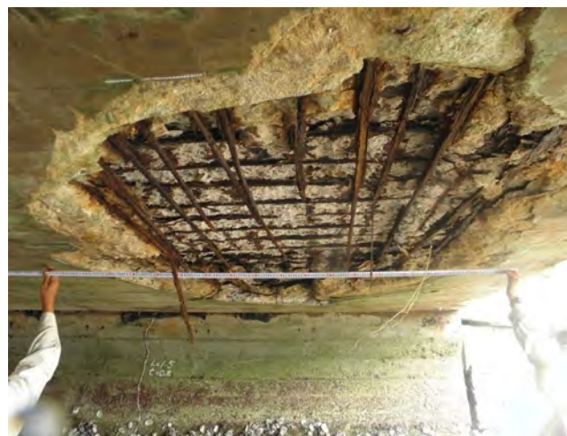
地方自治体管理 床版鉄筋露出
