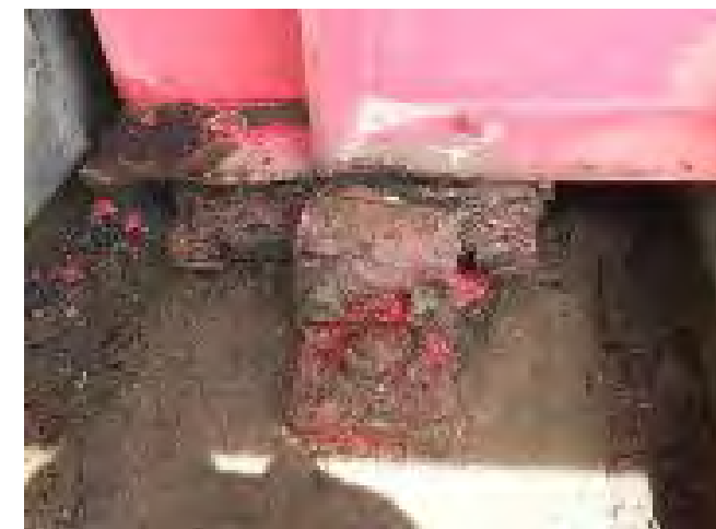
地方自治体管理 支承腐食
