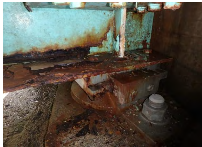
地方自治体管理 主桁腐食
