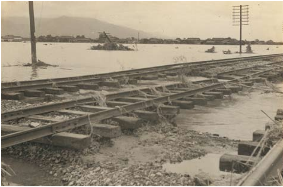
撮 影 日：昭和28年6月頃 撮影場所：鞍手郡剣村小牧の筑豊本線線路より 撮影内容：犬鳴川が遠賀川へ合流する地点。洪水により植木 側堤防決壊する。（線路レールが曲がり、浮き上 がっている） 写真提供：松尾 治己
