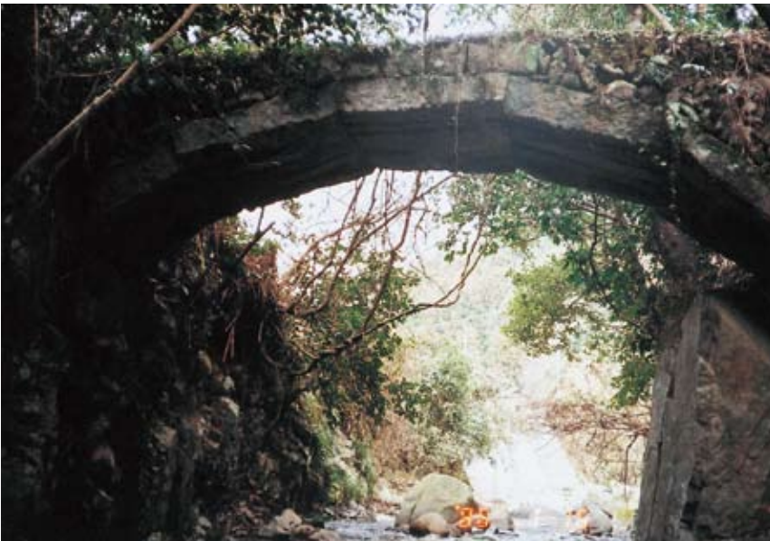
撮 影 日：昭和61年1月16日 撮影場所：桑野の掛橋一添ヶ倉（仙道橋） 撮影内容：昭和58年7月、大水害による遠賀川上流。貴重な石橋は残ったが、災害復旧の際に撤去。 写真提供：江藤 昌俊
