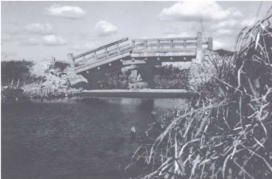
撮 影 日：昭和28年8月頃 撮影場所：上木月 撮影内容：水害による橋破損（樋道橋） 写真提供：栗田 利定
