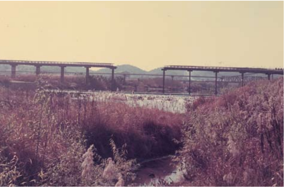
撮 影 日：昭和51年1月頃 撮影場所：国道200号線沿い勘六橋方向 撮影内容：台風の影響で壊れてしまったと思われる新橋 写真提供：原田 満
