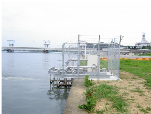
写真 18 河口堰の水質保全施設
