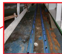
ゲート内部腐食状況
