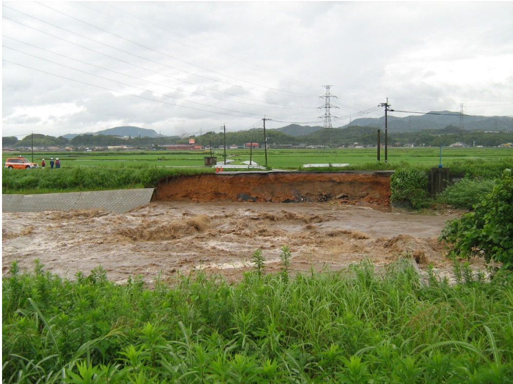
写真 2.1.1 遠賀川西郷地区堤防被災状況（嘉麻市）
