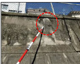
コンクリート剥離
