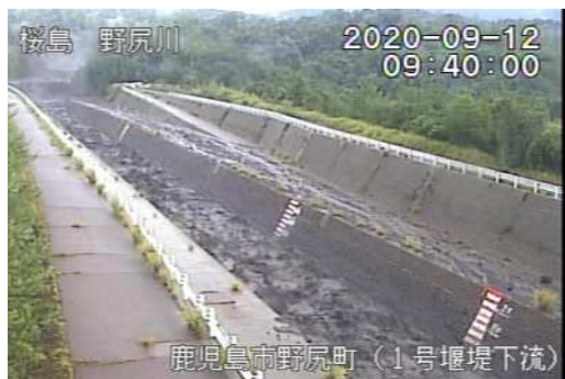
野尻川土石流の様子(9月12日)
