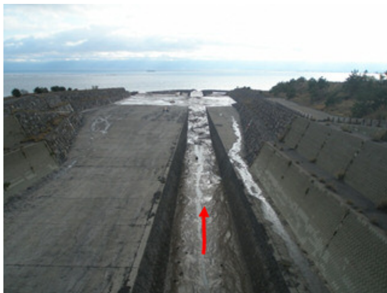
※河口から0k300付近まで土砂堆積が見られる。
