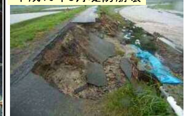
始良川右岸6k400付近 堤防崩壊状況
