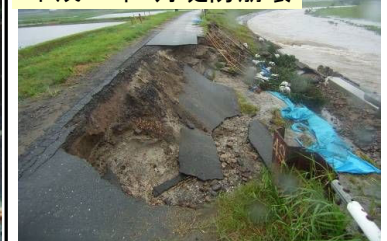
始良川右岸6k400付近 堤防崩壊状況
