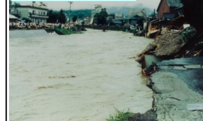
肝属川18/200付近 (朝日橋上流左岸)被害状況
