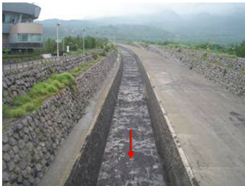
※顕著な土砂堆積は見られない。
