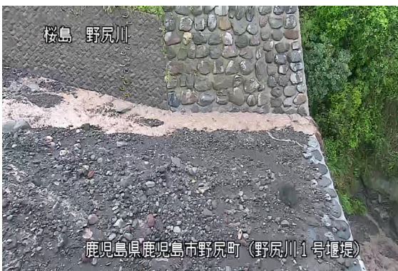
野尻川土石流の様子(4月10日)
