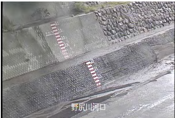
野尻川 土石流の様子(5月3日)
