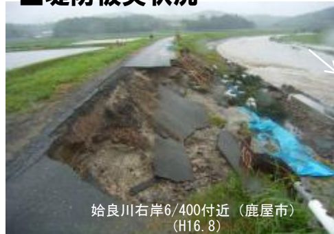
■堤防被災状況
