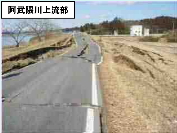
地震による堤防の被災状況
