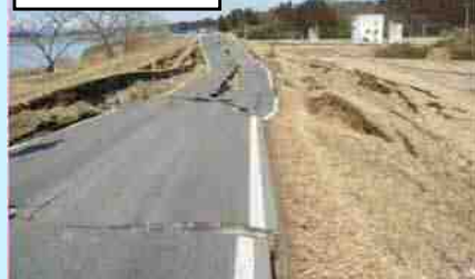
地震による堤防の被災状況
