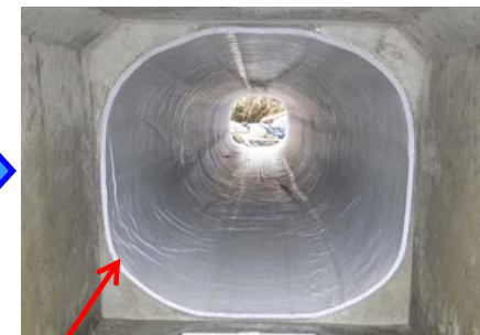
老朽化した函体の修繕
