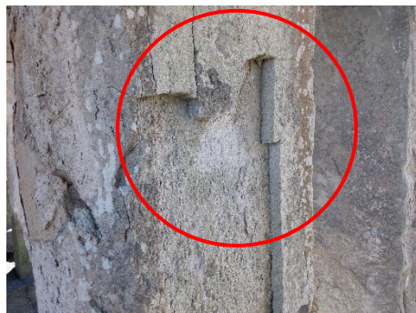
写真-1.1 板状剥離の発生事例
