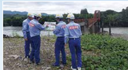
橋梁の変状に関する相談(現地調査)
