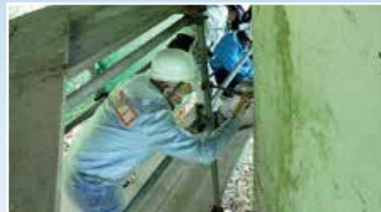
橋脚損傷に関する相談(現地調査)
