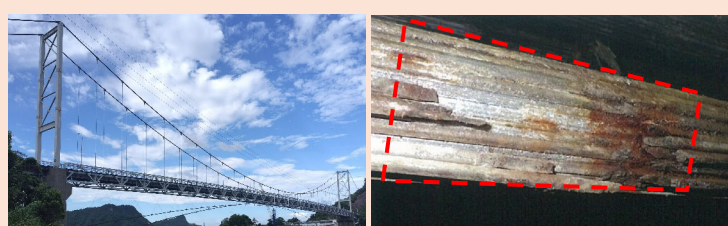
③樋島大橋（熊本県 上天草市）：主ケーブルの腐食・破断等
