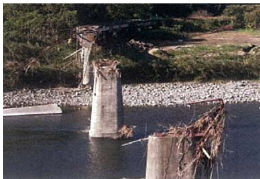
▲ TR高千穂鉄道被災状況 (H17.9)
