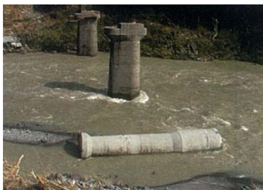
▲ TR高千穂鉄道被災状況 (H17.9)
